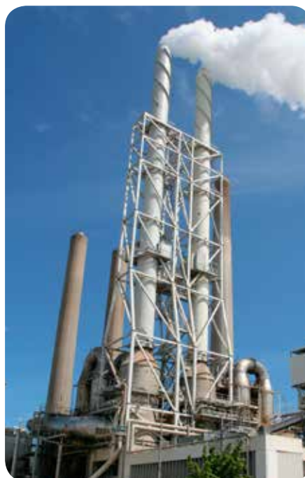
Anlæg til varmegenvinding og levering af fjernvarme
