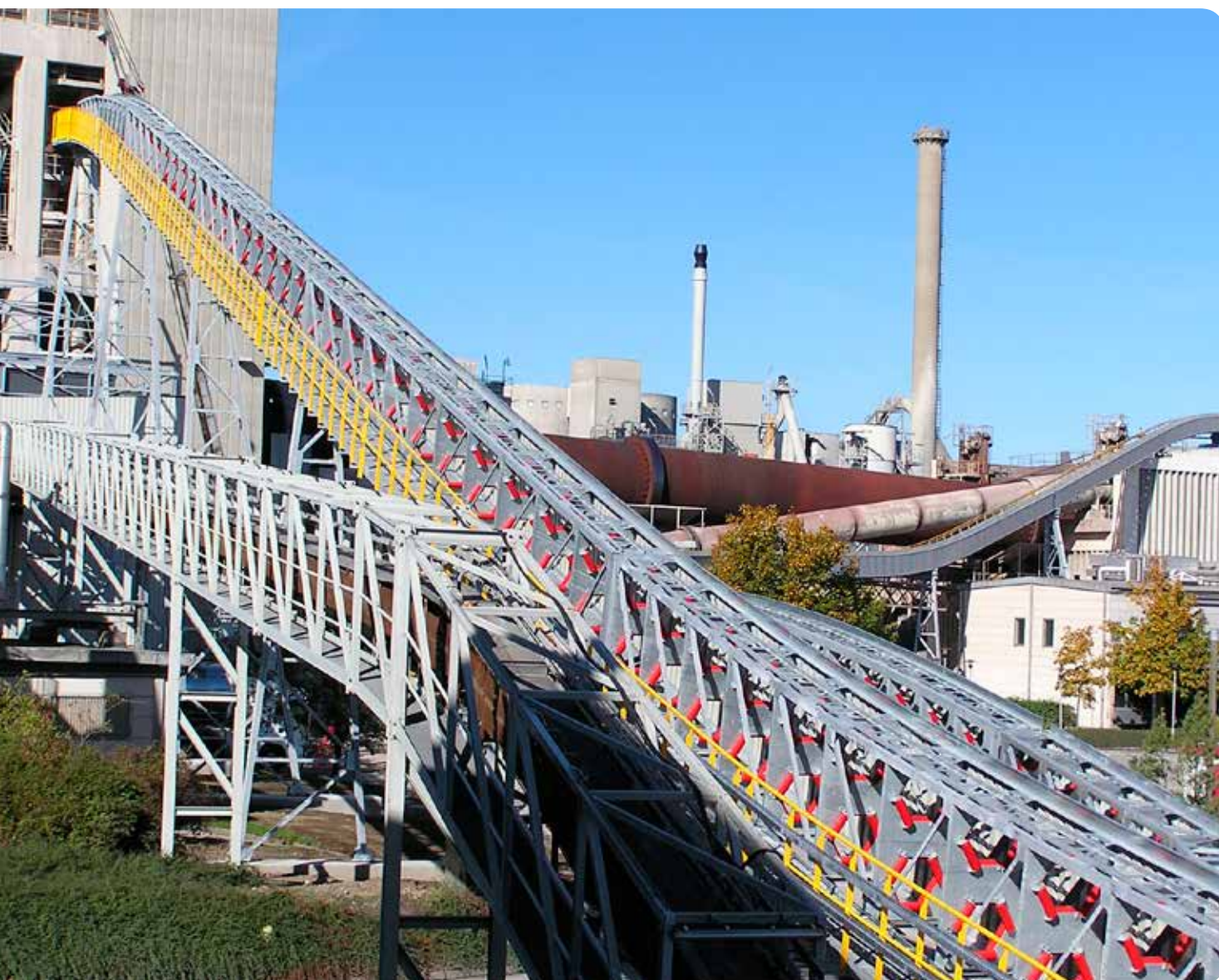
Opførelse af nyt anlæg for transport og indfødnng af alternativt brændsel til ovn 87
