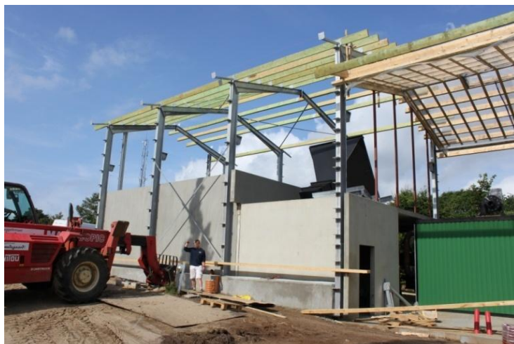
Figur 8-8 Hvalpsund Kraftvarmeværks nye fliskedel
